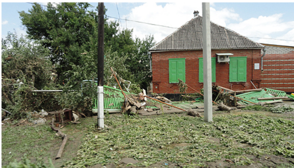
Рис. 2. Отметки высоких вод на стене дома в г. Крымск (9 июля 2012 года) (Здесь и далее фотографии заместителя руководителя Кубанского БВУС. В. Сапранова)
